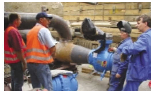
An die Ausmaße des Kellers eines Einfamilienhauses erinnern unterirdische Bauwerke, in denen die Fernwärmeleitungen miteinander verbunden werden
