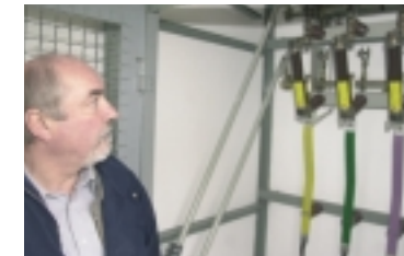
Bodo Diesenberg inspiziert die Schaltanlage
