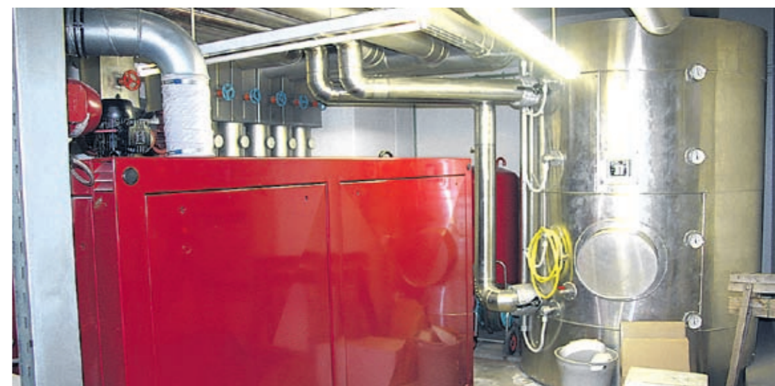
Mini-BHKW: Die Kieler Stadtwerke haben in der Schwentiner Astrid-Lindgren-Grundschule ein Blockheizkraftwerk aufgestellt, das durch die umweltschonende Kraft-Wärme-Kopplung gleichzeitig Strom und Wärme erzeugt.
