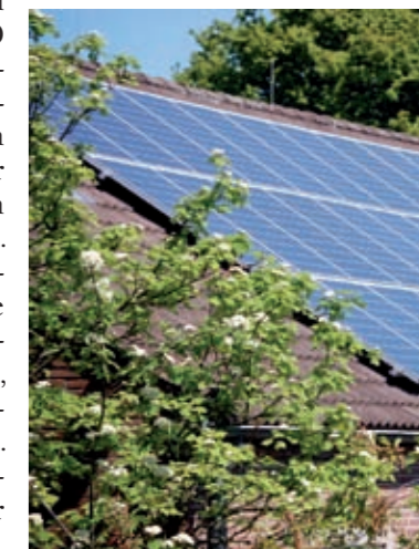
Strom vom Dach: Die 80 Quadratmeter große Anlage fängt die Sonne ein.
